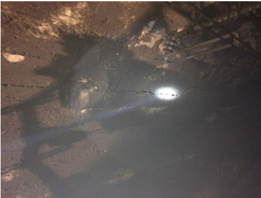
Figura 5 fessurazioni lungo il tratto di imposta del calottino
