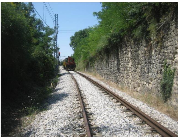
Figura 14 Muro al km 95+350- stato prima intervento
